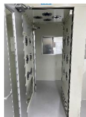
クリーンルーム エアシャワー室
