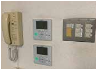
エアコン類・照明スイッチ
