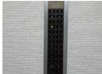
エレベーターボタン
